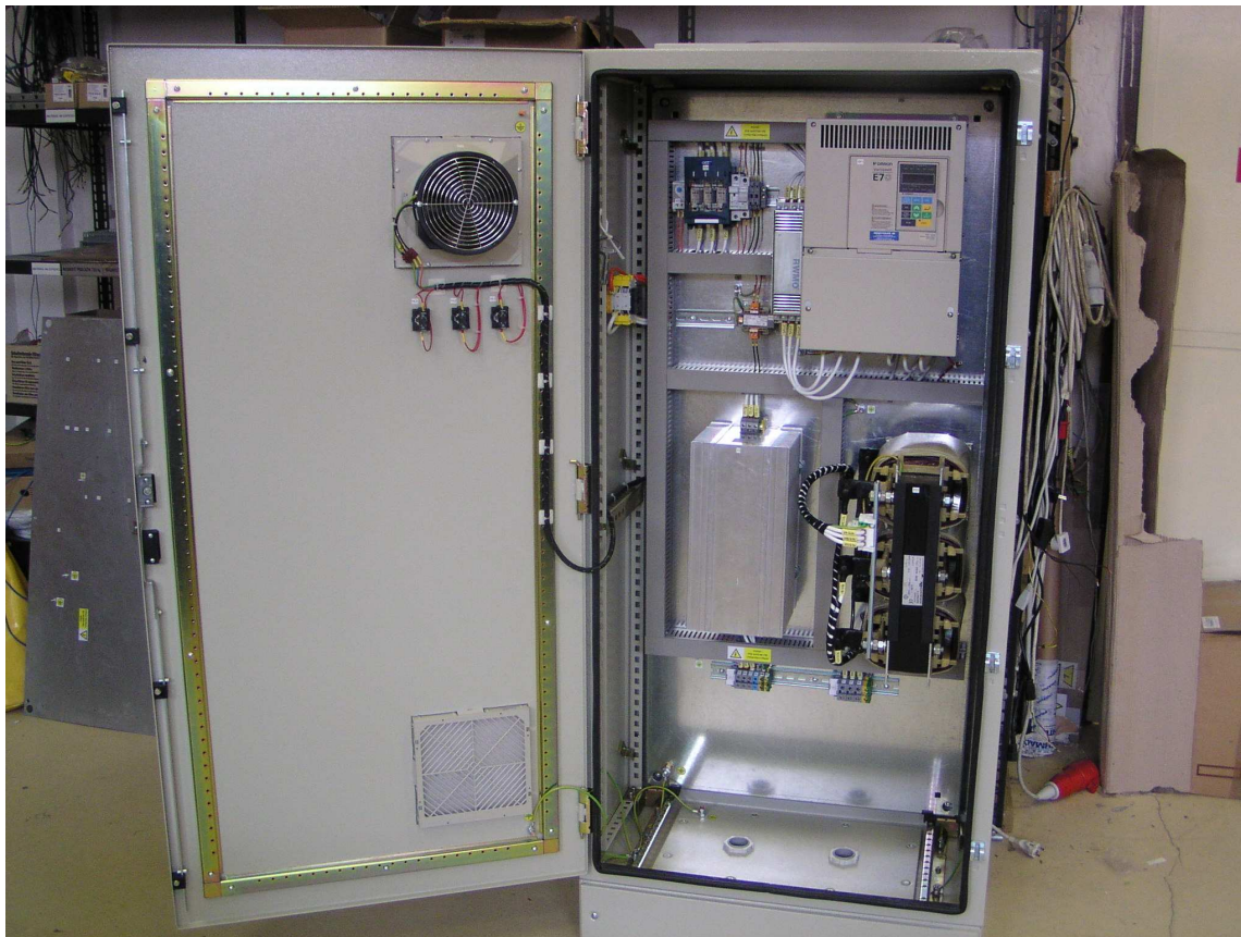
Obr.3: Rozváděč zdroje 22kW.
