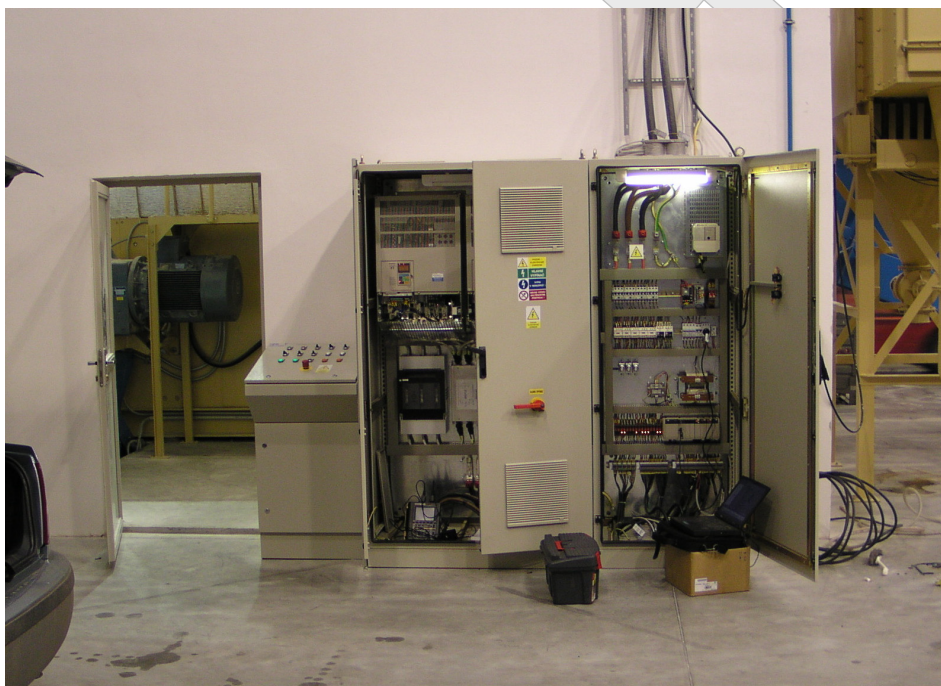
Obr.2: Rozváděče s měniči, ovládací pult.
