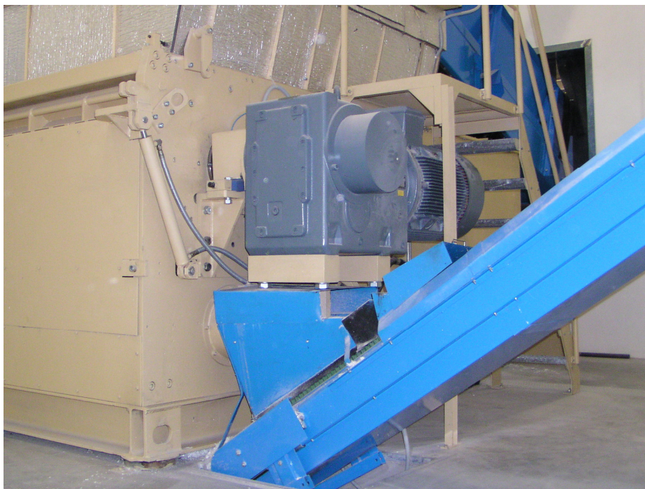
Obr.1: Letmo uložený pohon 90kW a vynášecí dopravník.
